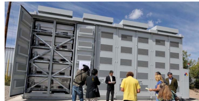
Los Alamos, NM. 1 MW, 6MWh
