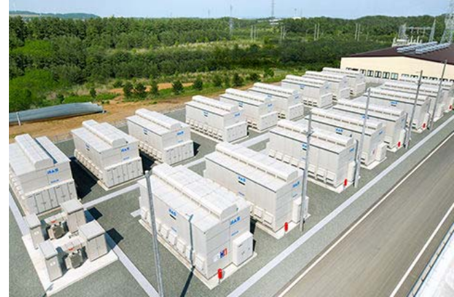
NGK 34MW - 245 MWh NaS, Rokkasho, Japan
