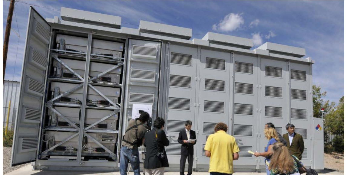
Los Alamos, NM 1 MW, 6MWh NaS system
