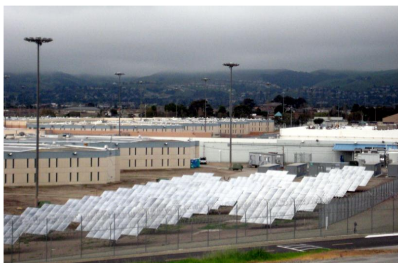
图 4: 圣塔瑞特监狱近照： 地面安装跟踪式太阳能光伏居前、电池和燃料 电池居后
