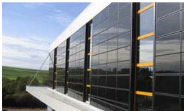
Figur 11: Tynnfilm solcellemoduler integrert i fasade [14].
