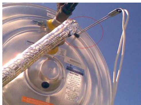
Figura 3. Detalhe do poço para sensor de temperatura no “boiler”
