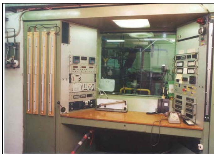
Figura 3. Quadro di controllo e acquisizione dati della sala prova del motore a gasolio
