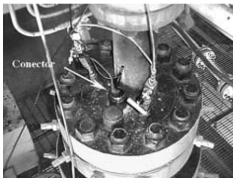
Figura 8. Conector del equipo de fondo del Sistema BEC, utilizado para la aplicación de pulsos, el cual está localizado en la parte superior del árbol de válvulas.
