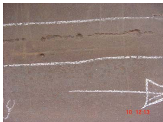
Foto 6. El efecto de Erosión – Corrosión junto a Corrosión por CO 2 .
