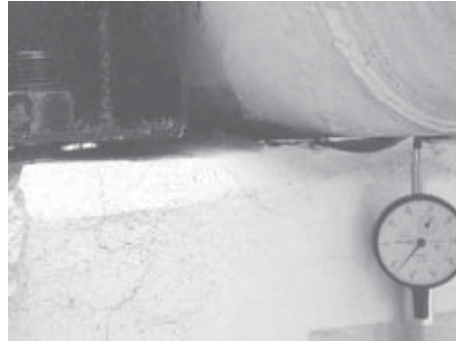
Figura 4. Soporte de tubería trabajando a tensión.
