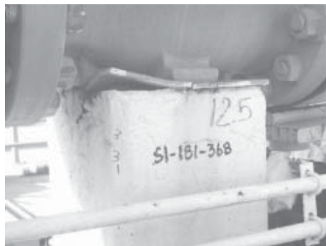
Figura 1. Soporte de tubería trabajando a compresión.
